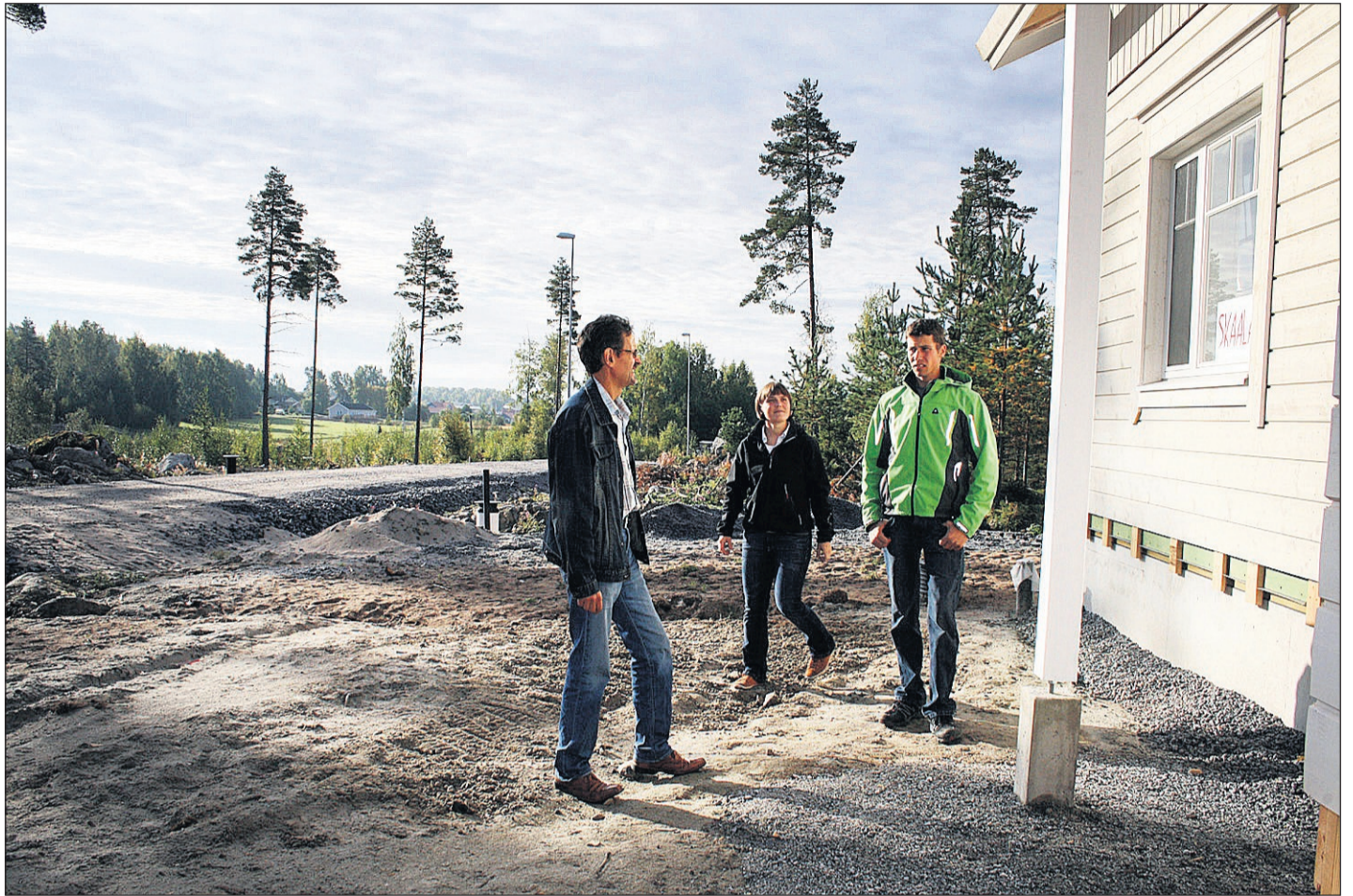
Andreas Eklund och Jessica Joutsu har kommit en bit på väg med sitt husbygge. Tomter är till salu både på andra sidan vägen och bakom paret på bilden. Markku Niskala (till höger) är den på kommunen som har hand om tomtförsäljningen. FOTO: ANNA GAMMELGÅRD
